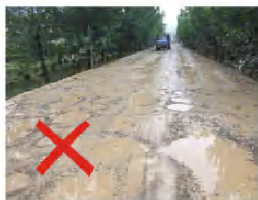
坑洼、颠簸路面
